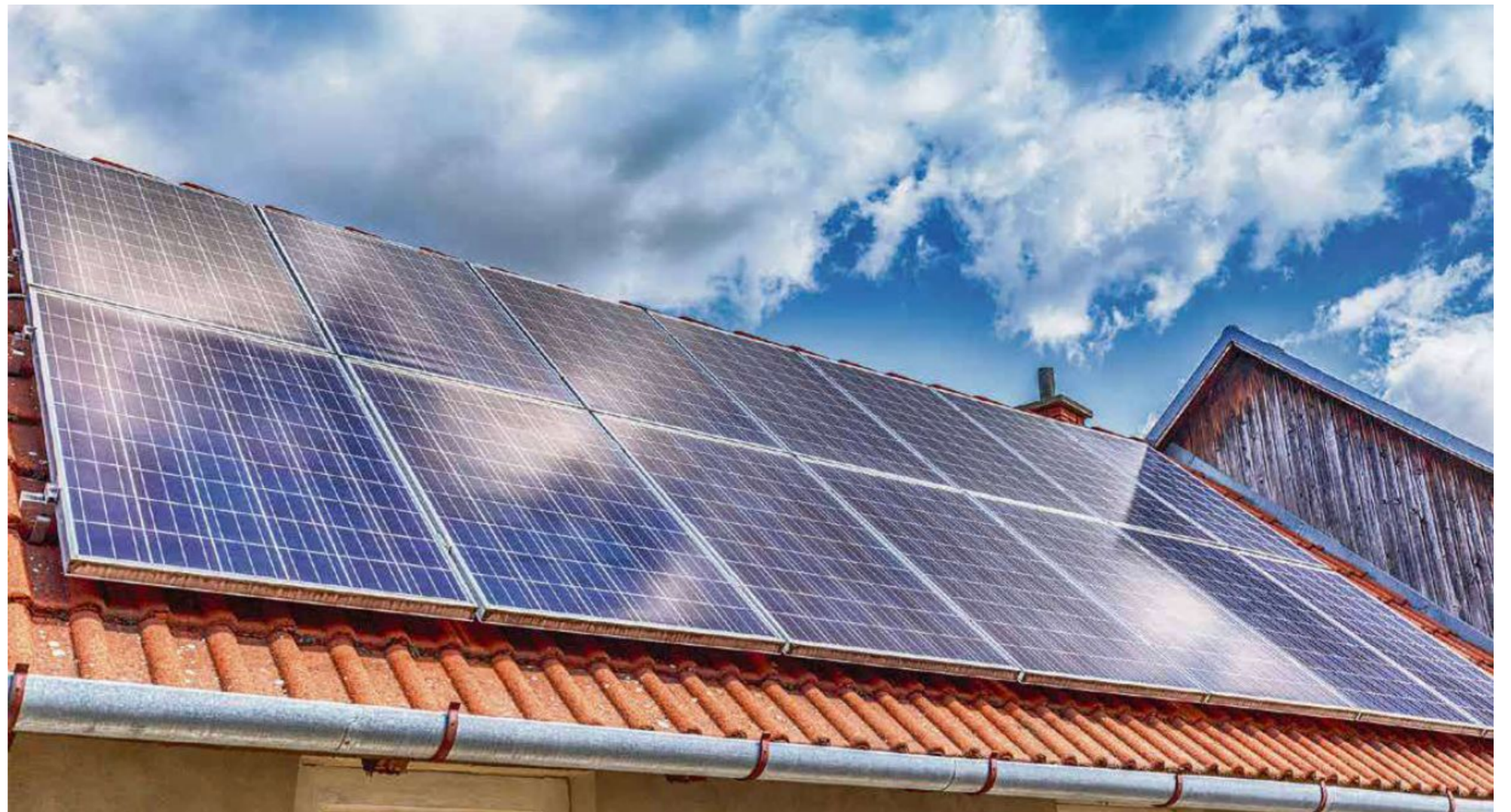
Strom selber zu erzeugen ist ein wichtiger Baustein für eine zukunftsfähige Energieversorgung des eigenen Hauses.
