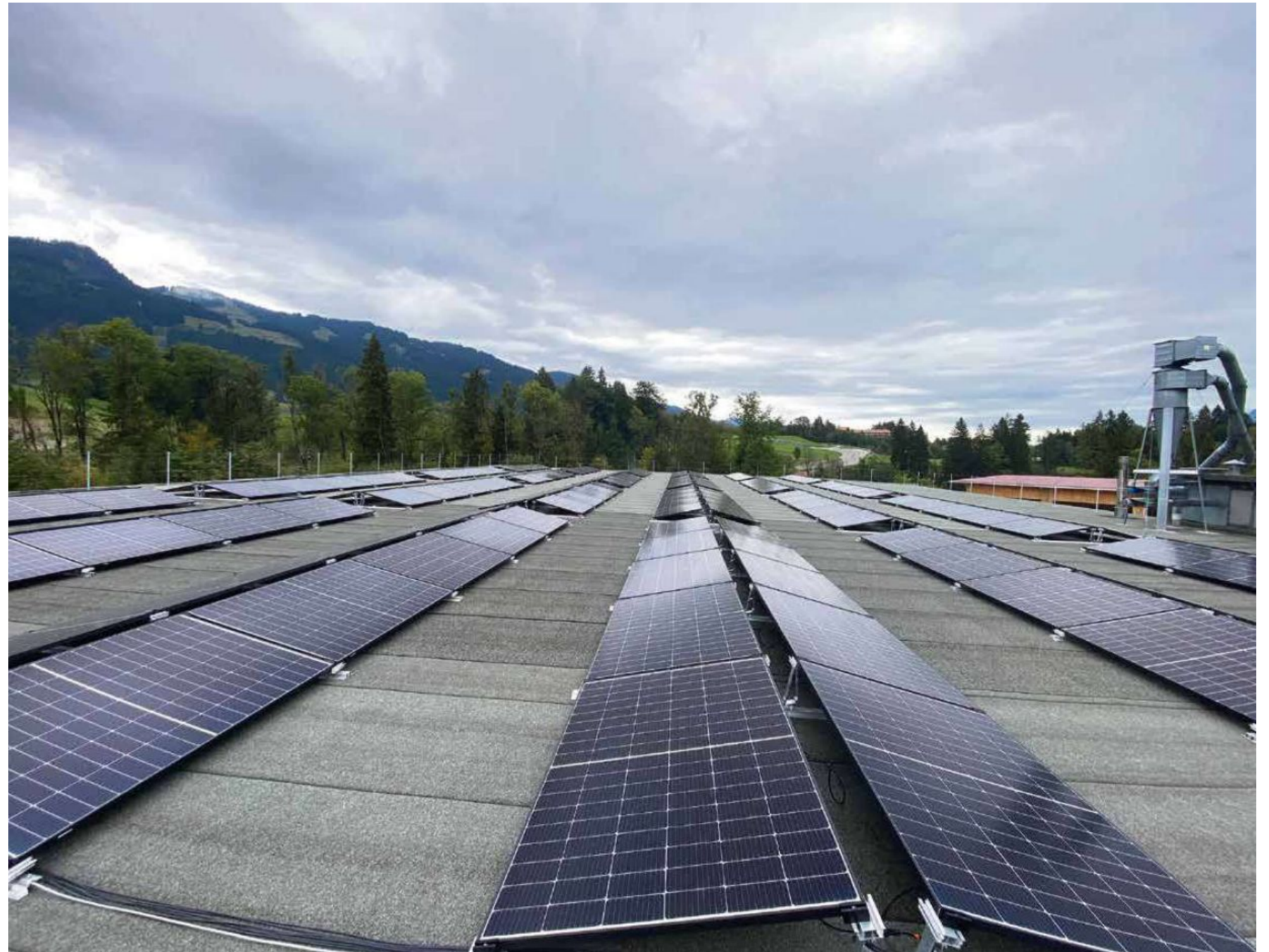
Die Photovoltaikanlage auf dem Dach liefert unter anderem den Strom für die gesamte Lüftungs- und Klimatechnik.
